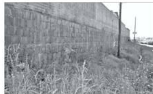
Com a chuva, resíduos liberados pelo muro da empresa alagam a travessa e as residências
