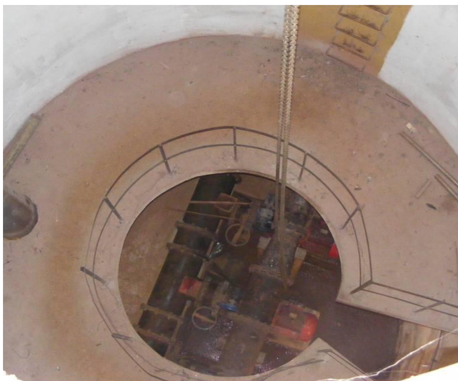
Figura 17: Interior da torre de tomada e as 2 bombas paralelas de 65 cv.
