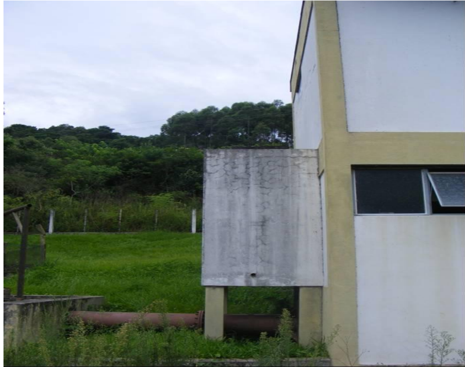
Figura 18: Unidade de recalque.
