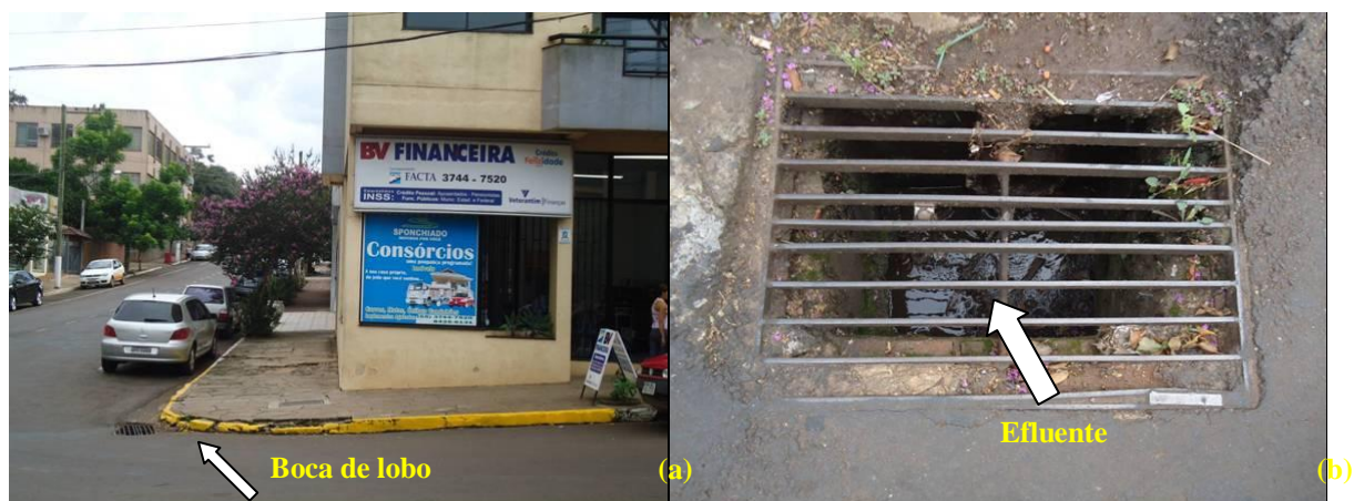
Figura 91: (a) Fotografia da boca de lobo existente na esquina entre as ruas Aparício Borges e Presidente Kennedy no centro; (b) Fotografia superior da boca de lobo que apresenta efluente de origem desconhecida e odor característico a esgoto sanitário.
