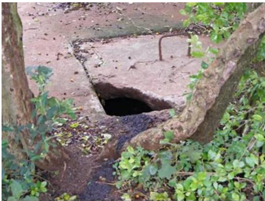
Figura 45: Local adaptado à descarga de lodo do caminhão limpa-fossa – Tampa de inspeção da fossa séptica da ETE com o canto quebrado.
