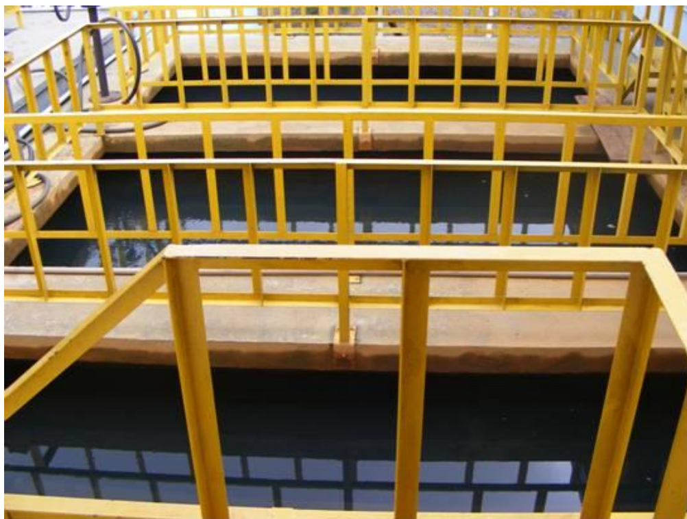
Figura 27: Filtragem – 3 filtros ascendentes em paralelo
