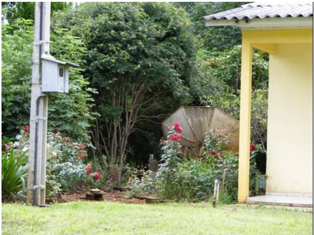
Figura 32: Residência da Linha Encruzilhada com hidrômetro.
